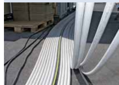
Durch diese Kabelstränge floss die Energie.
