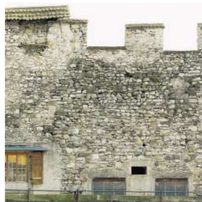
Zustand der Mauer vor ihrer Sanierung – mit mittlerweile zugemauerten Fenstergruppe rechts unten
